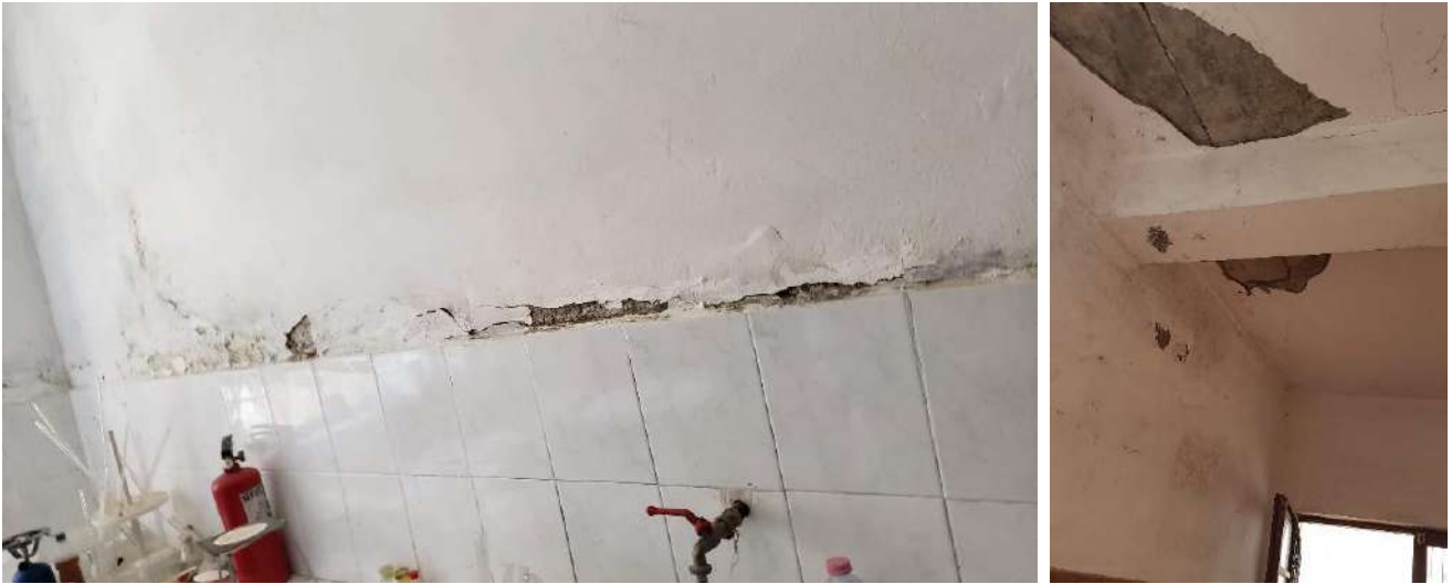
Figura 14-15. Foto të mureve dhe tavanit me probleme lagështie të laboratorit TIK
