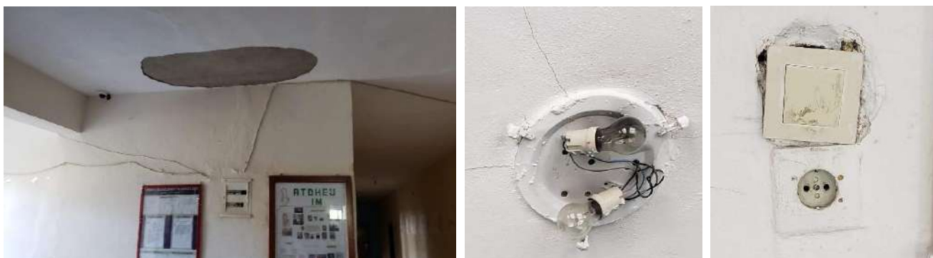
Figura 26-28. Foto të rrjetit elektrik
