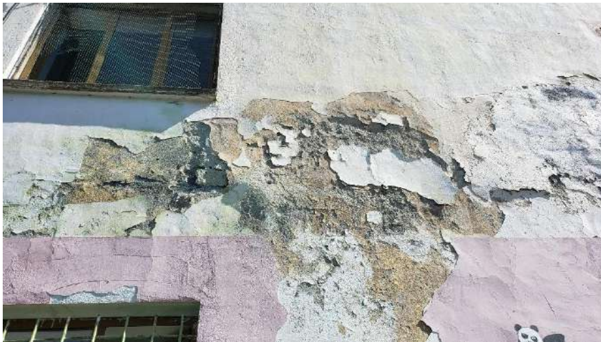
Figura 15. Foto të mureve të fasadës me probleme lagështie
