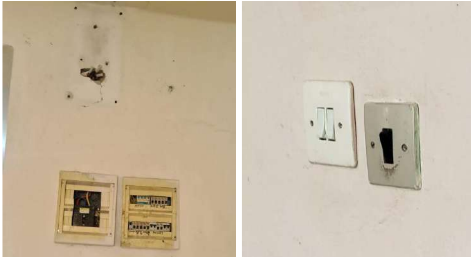
Figura 19-20. Foto të rrjetit elektrik të shkollës
